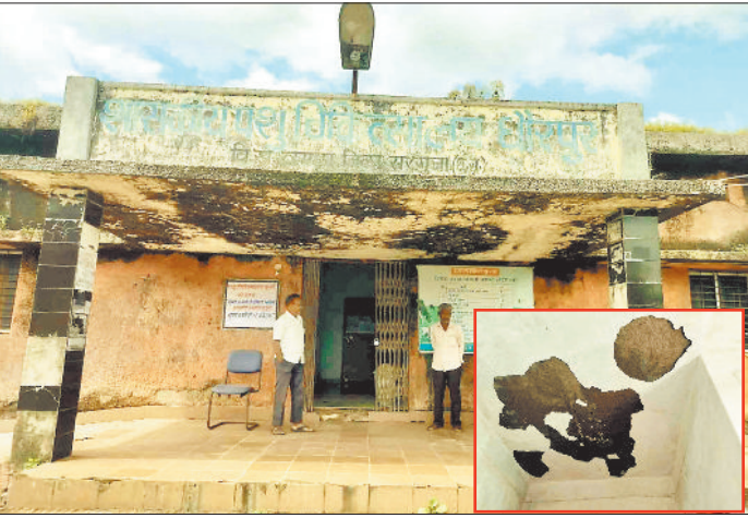
जर्जर पशु चिकित्सा भवन।
